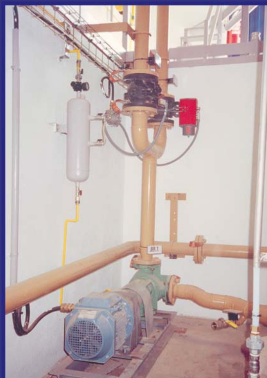
Detalle de trasiego de tanque de isocianato a batidora
